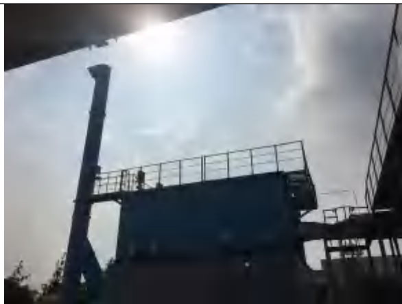
喷金废气处理设施
