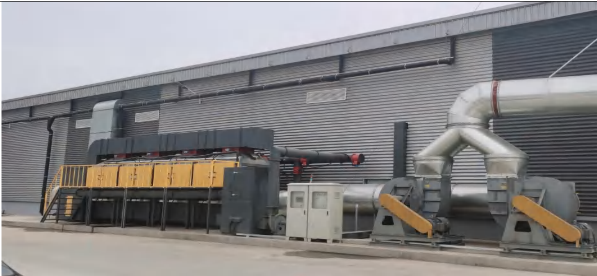
废气处理设施
