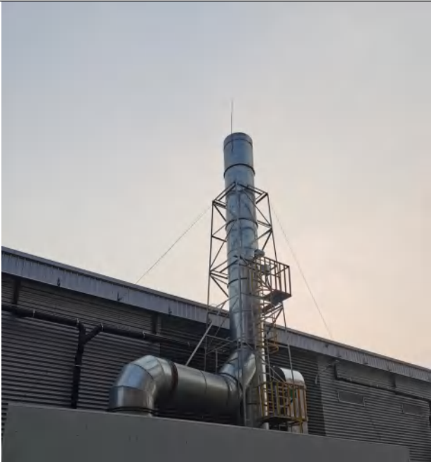
废气排气筒废气排气筒 FQ-11
